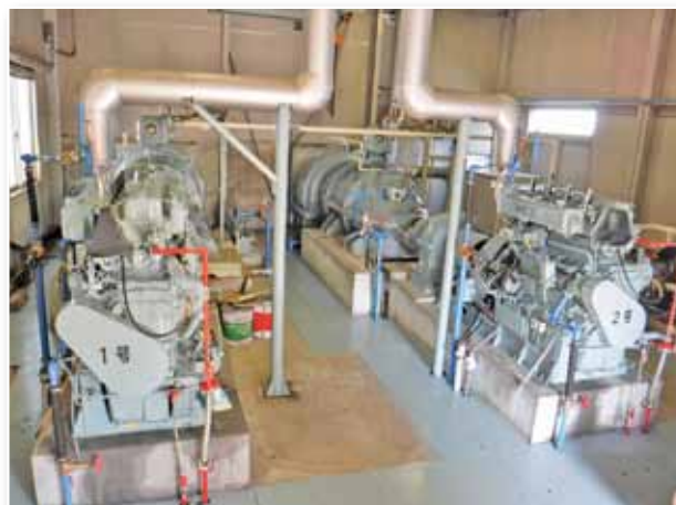
ポンプ長期補修計画 (船江ポンプ場)
